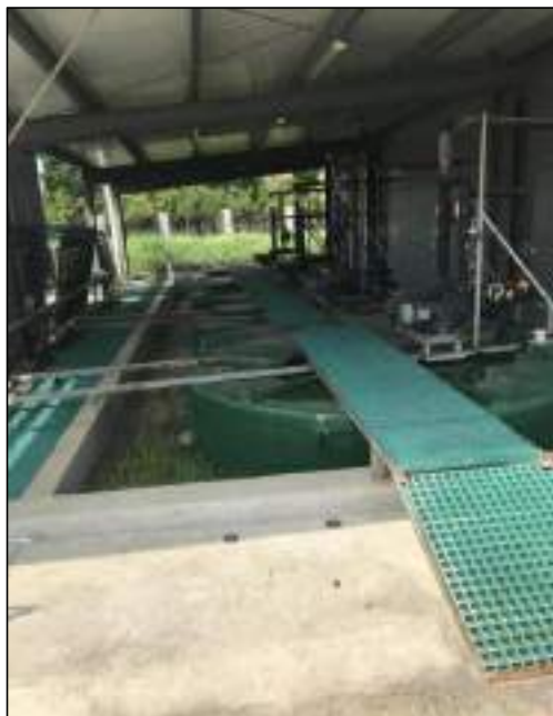
(a) 污水处理区
